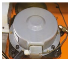
Motor elétrico do martelo
